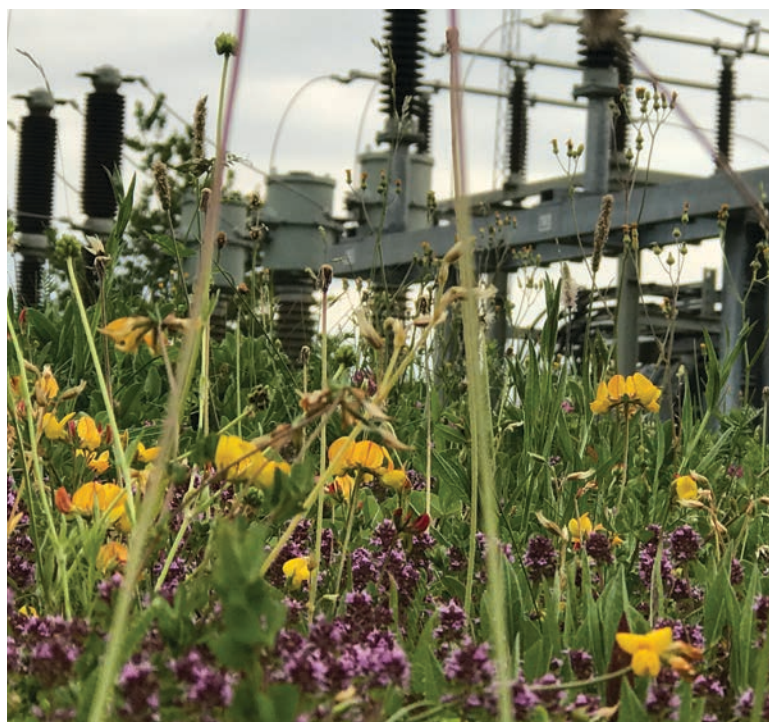
Ein gedeckter Tisch aus Insektenperspektive: Das Umspannwerk nahe Donnstetten ist ein dankbarer Standort. Hornklee und Thymian waren schon da. Mit einer besonderen Magerrasen-Samenmischung wird hier die bestehende Flora aufgewertet. (© Roman Hein)
